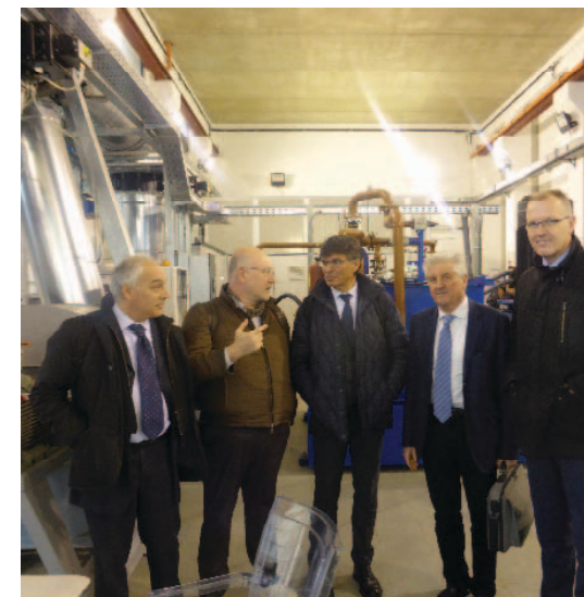
Gli uomini Bosch Rexroth verificano l'impianto assieme, secondo da destra, all'ing. Vincenzo Iommi dell'Istituto Giordano.
